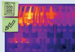
在故障发生前，及时识别电气 元件的异常温升
