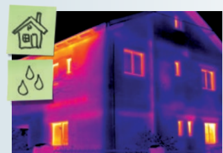
快速发现并记录建筑围护结构 中的热桥缺陷
