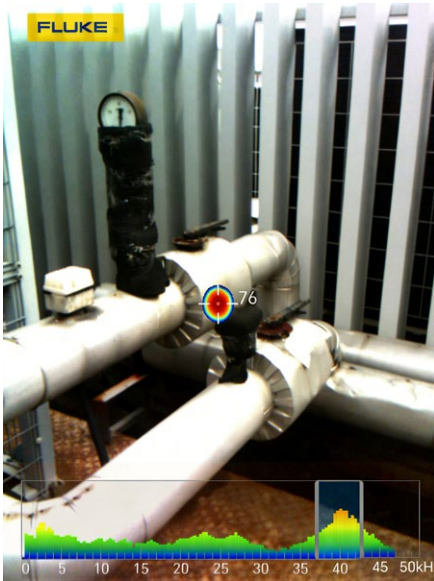
管道气体泄漏检测
